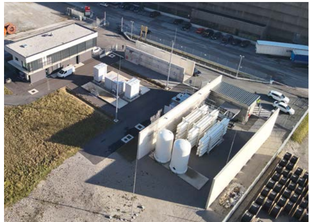
Die P2X-Anlage in Jenbach
