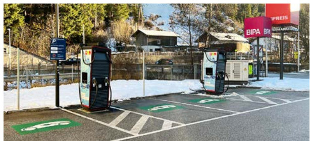
Bei der MPREIS-Filiale in Fulpmes wurden moderne E-Ladesysteme in Betrieb genommen.
