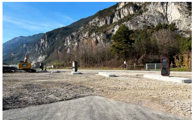
Für die elektrisch betriebenen LKW wurden auch in der Nähe des Baubüros in Haiming E-Ladesäulen installiert.
