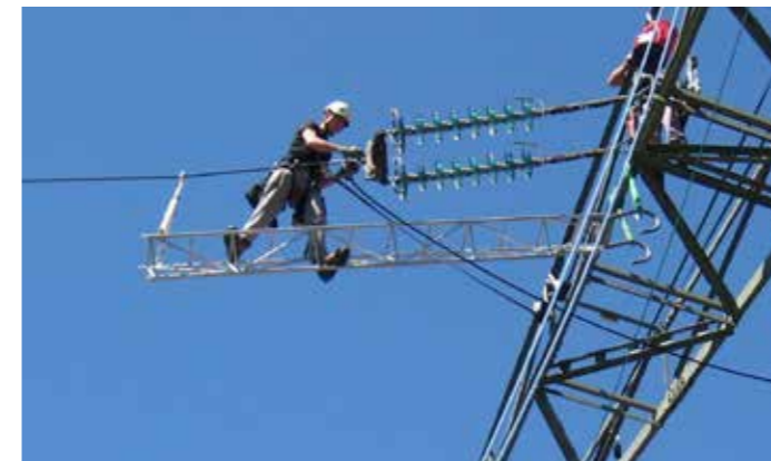
Hochwertige Stromversorgung (Quelle: TINETZ)
