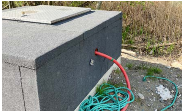
Die neue Stromanschlusstelle hilft, Schadstoffemissionen zu vermeiden.
