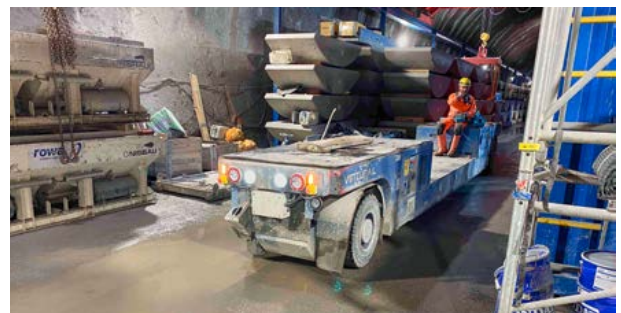
Im Vortrieb des Beileitungsstollens beim Erweiterungsprojekt Kühtai kommt ein vollelektrischer Baustellenzug zum Einsatz – der Virturail.
