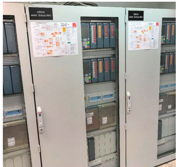
Die neuen elektrischen Schutzschränke im KW Kirchbichl.
