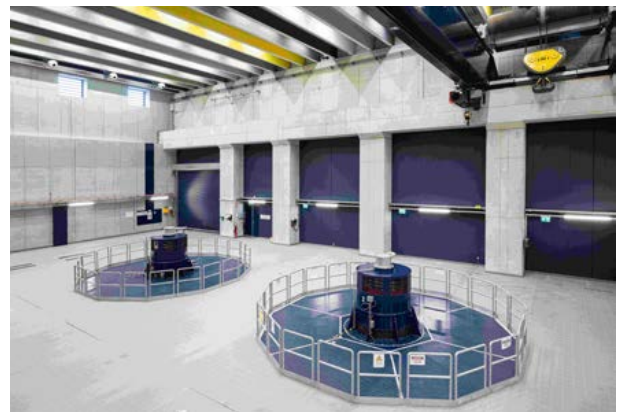
Die Maschinenhalle beherbergt zwei Maschinensätze.
