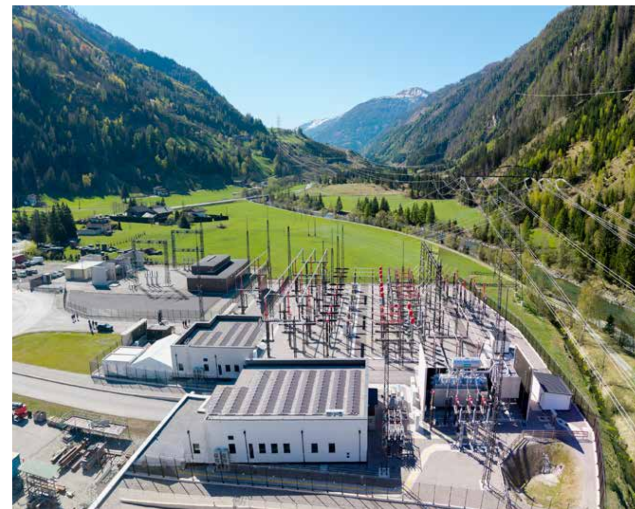
Aus der Vogelperspektive: Das neue UW Matrei erhöht die Ausfalls- und Versorgungssicherheit für Osttirol erheblich.
