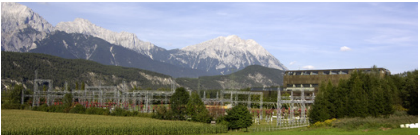
Freiluftschaltanlage und Krafthaus Silz
