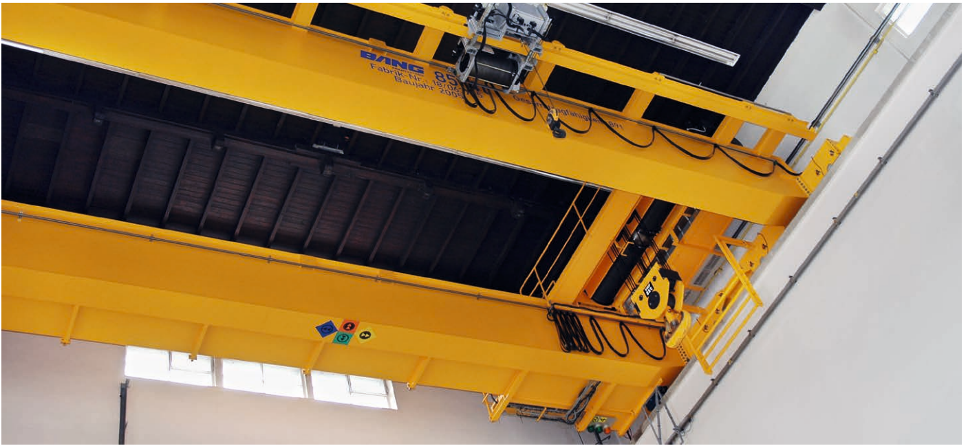
Laufkran in der Maschinenhalle
