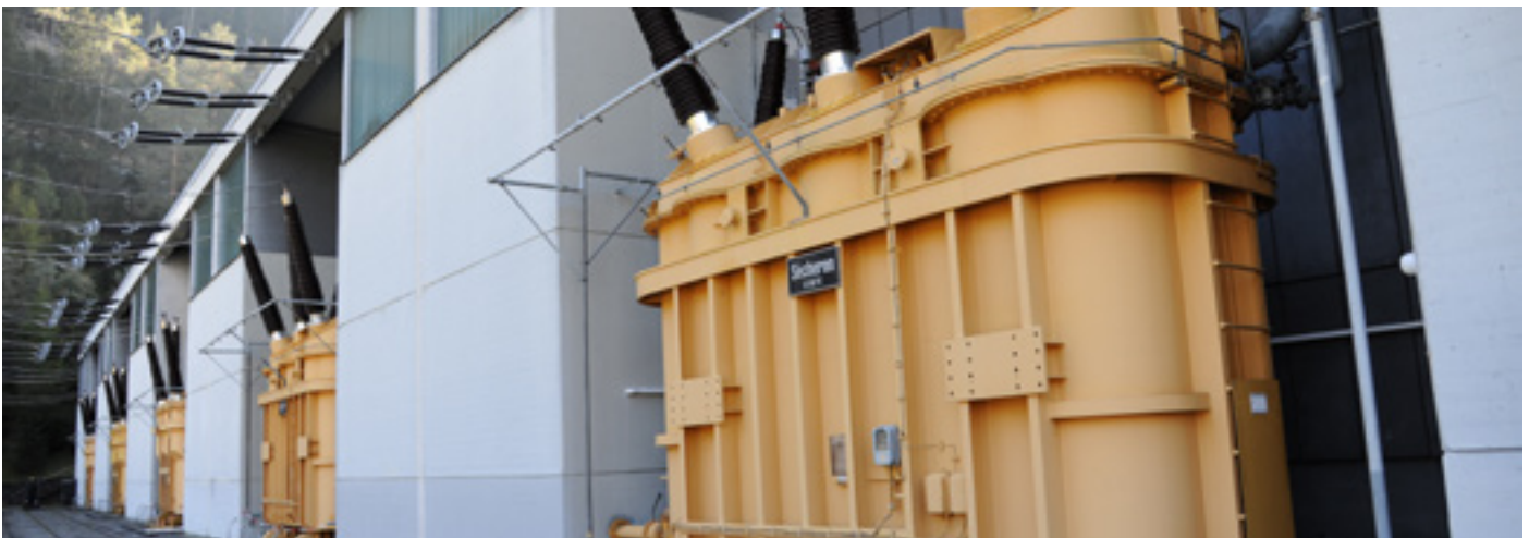
Anordnung der fünf Maschinentransformatoren
