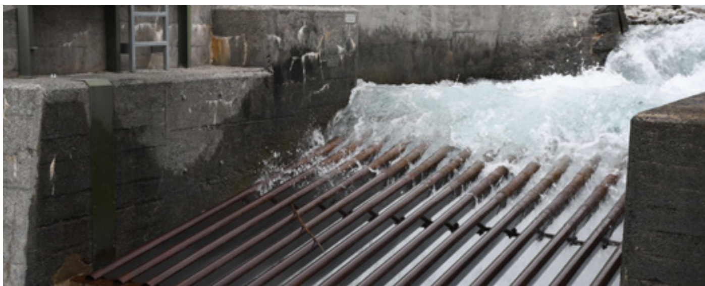
Die Verpeil-Wasserfassung nach dem Typ eines „Tiroler Wehrs“.
